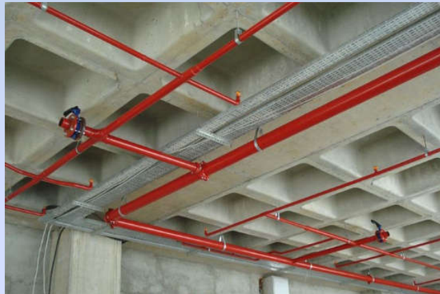
1-Sprinkler (Yağmurlama) Sistemleri (Sulu Sistemler, Köpüklü Sistemler)
